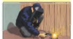
Нарушение правил противопожарной защиты зданий
